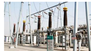
变电站无人值守监控
