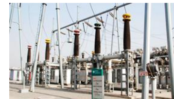
变电站无人值守监控
